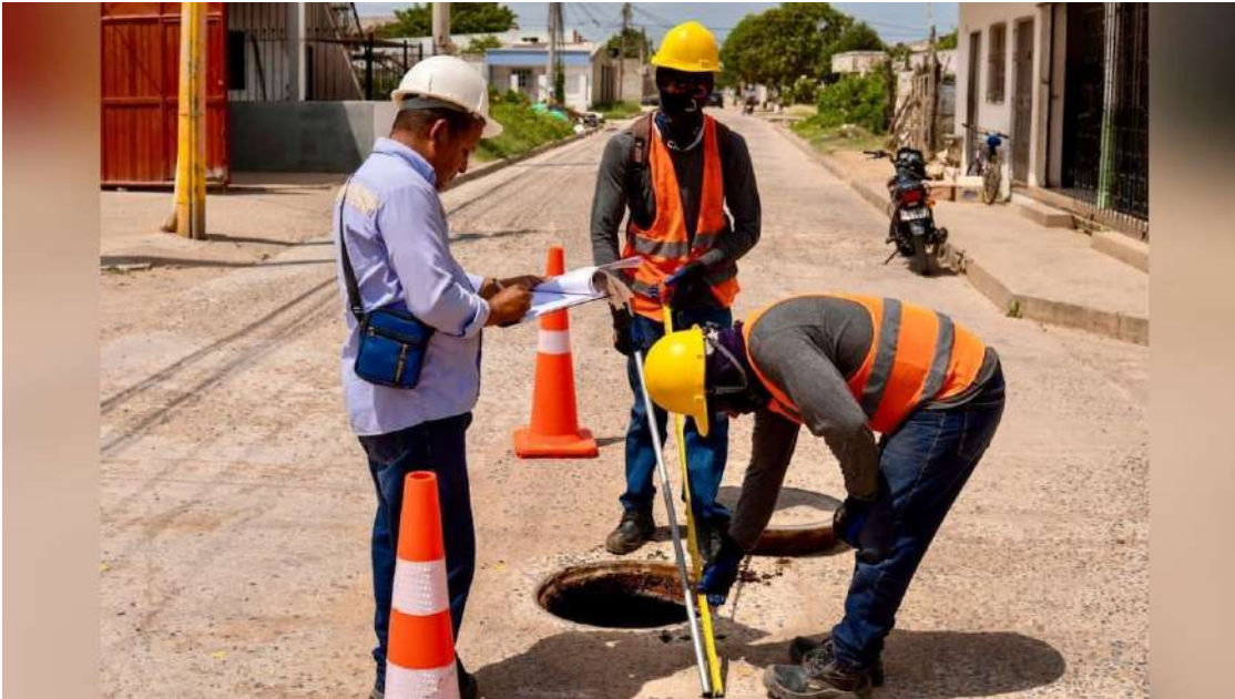
Sistema de alcantarillado en Riohacha.
