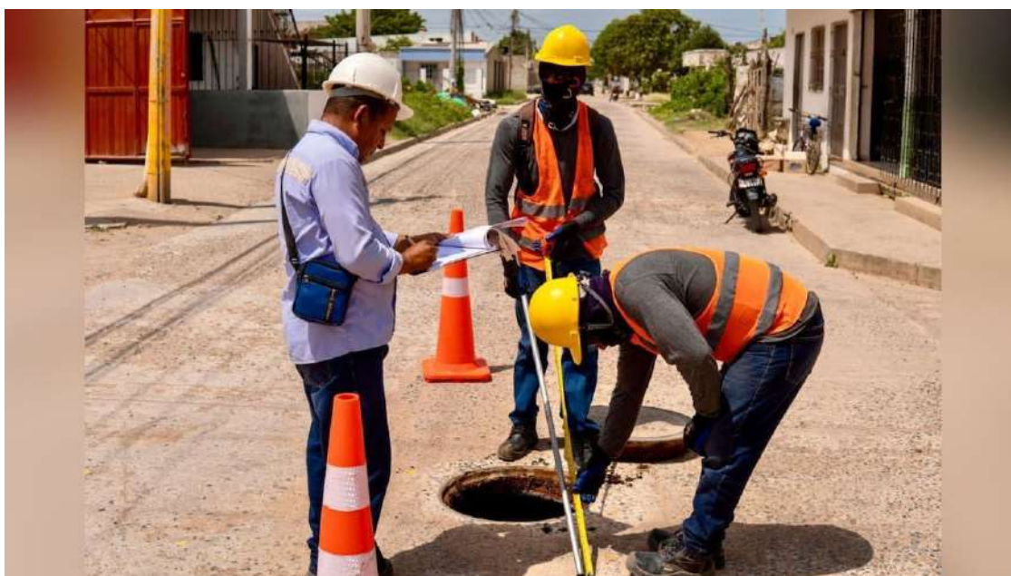
Sistema de alcantarillado en Riohacha.
